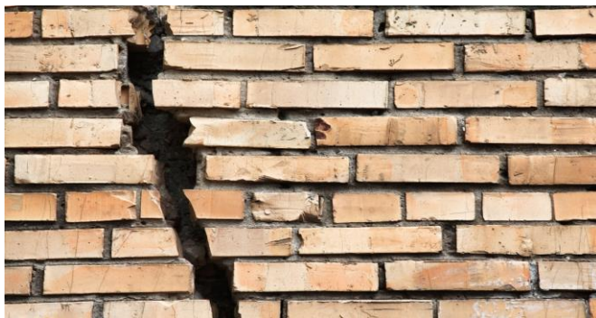
Рис.1 Трещина в кирпичной кладке
